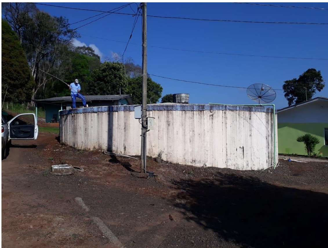
Figura 18. Reservatório de água.
